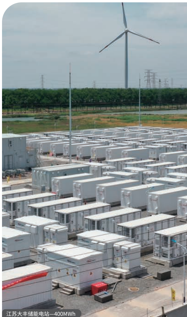
江苏大丰储能电站—400MWh
