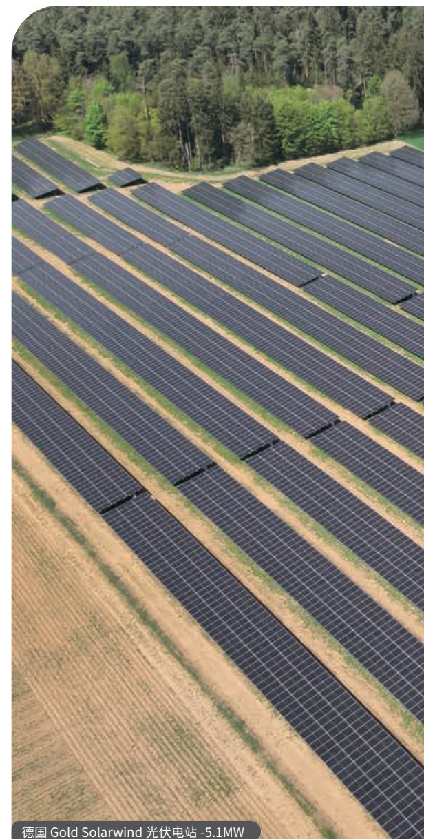
德国 Gold Solarwind 光伏电站 -5.1MW
